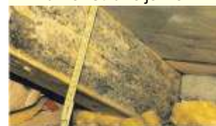
Građevinske štete u konstrukcijama
